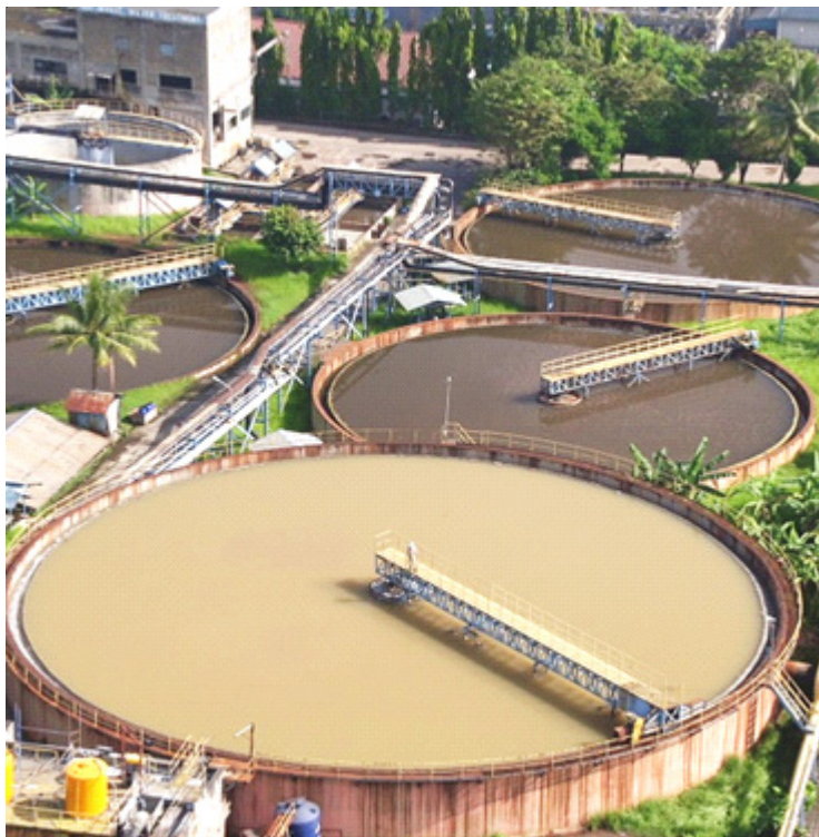
Gambar Instalasi Pengolahan Air Limbah Produksi
